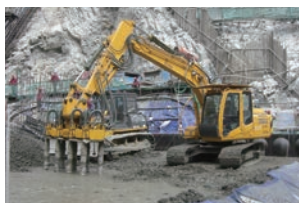
ダム現場での使用風景
